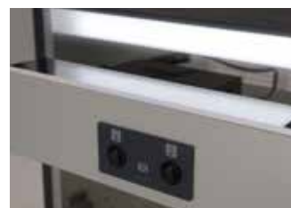
Niche technique avec multiprise 4 entrées
